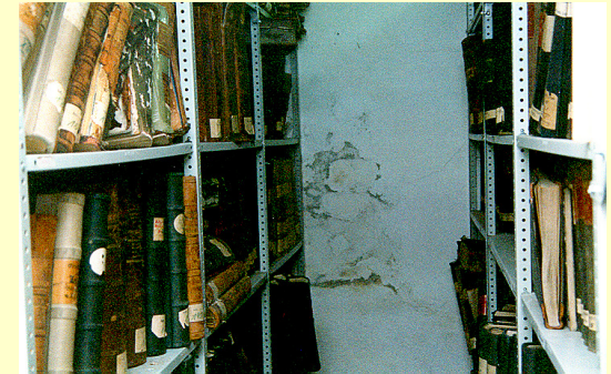
Schimmelpilzbefall im Archiv
